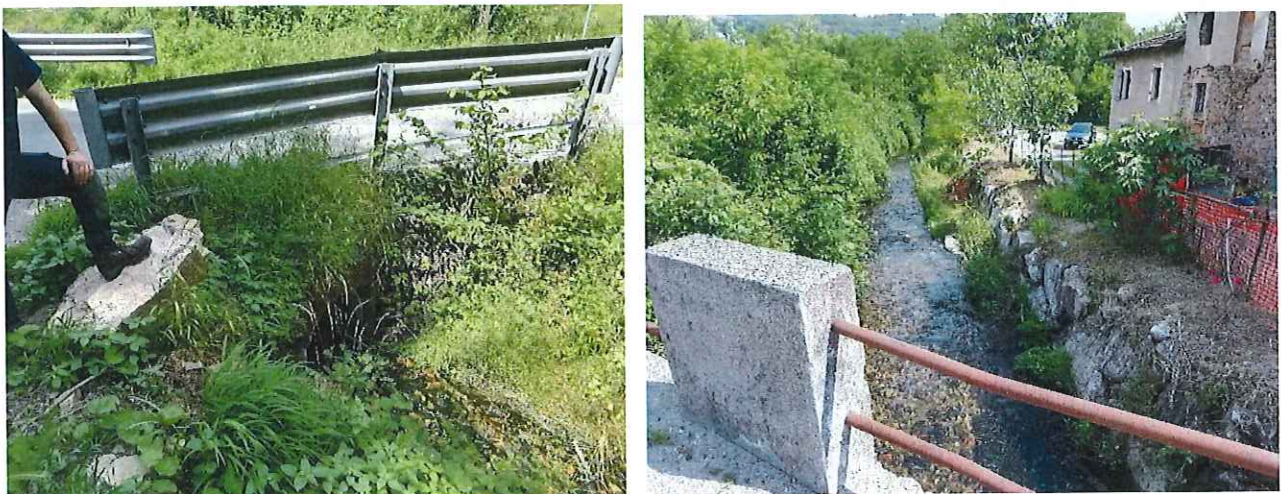
Foto – Attraversamento intubato torrente minore – via per Cuasso al Piano (sx). Ponte di via Besano con abitazioni sponda destra in Comune di Besano
